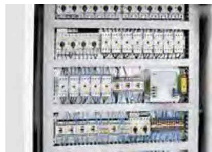
独立电控柜带冷却装置，每台马达配独立变频器
